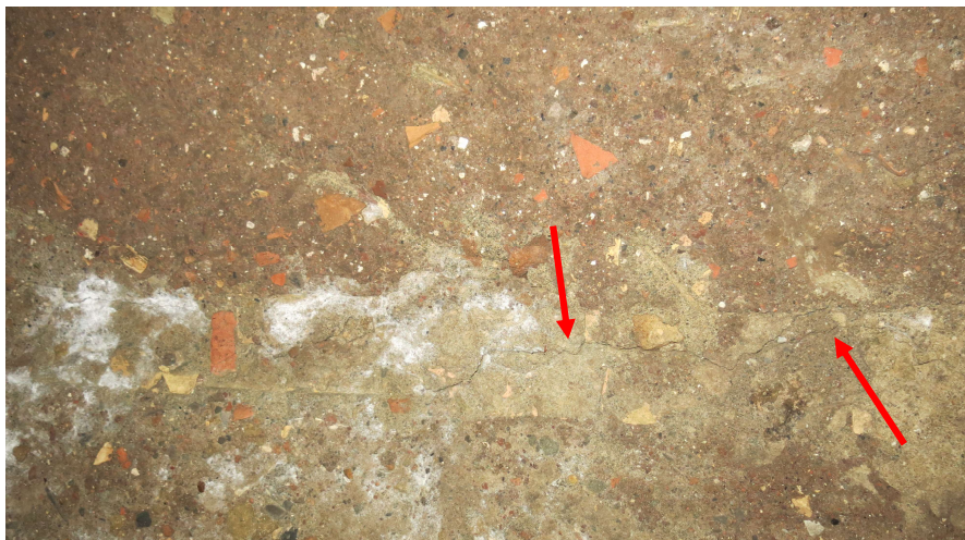
Presenza di una sezione di discontinuità sulla superficie di intradosso della volta
