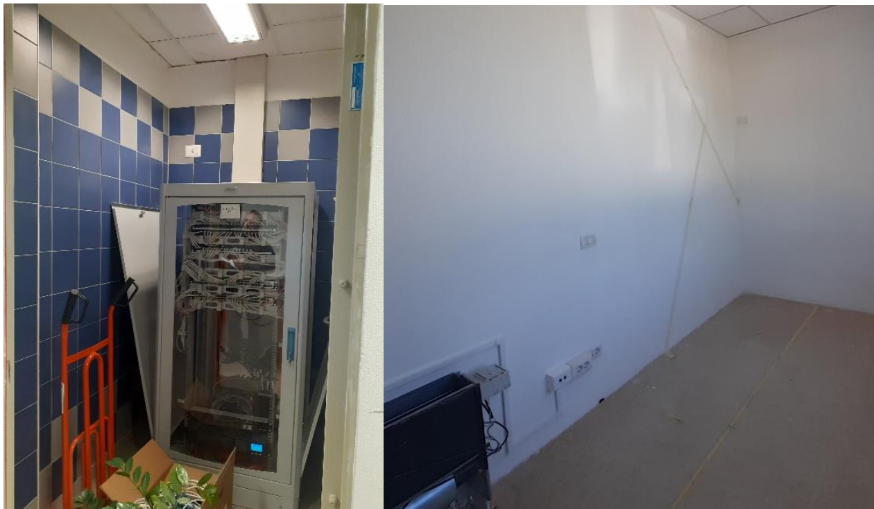
Infrastruttura di rete con rack di server ed esempio di prese LAN.
